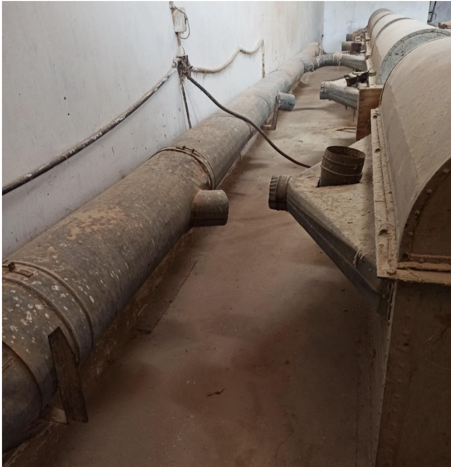
Figura 57. Vista das tubulações que direciona o pó residual das fibras de sisal, CAMPOL, Pocinhos, PB.
