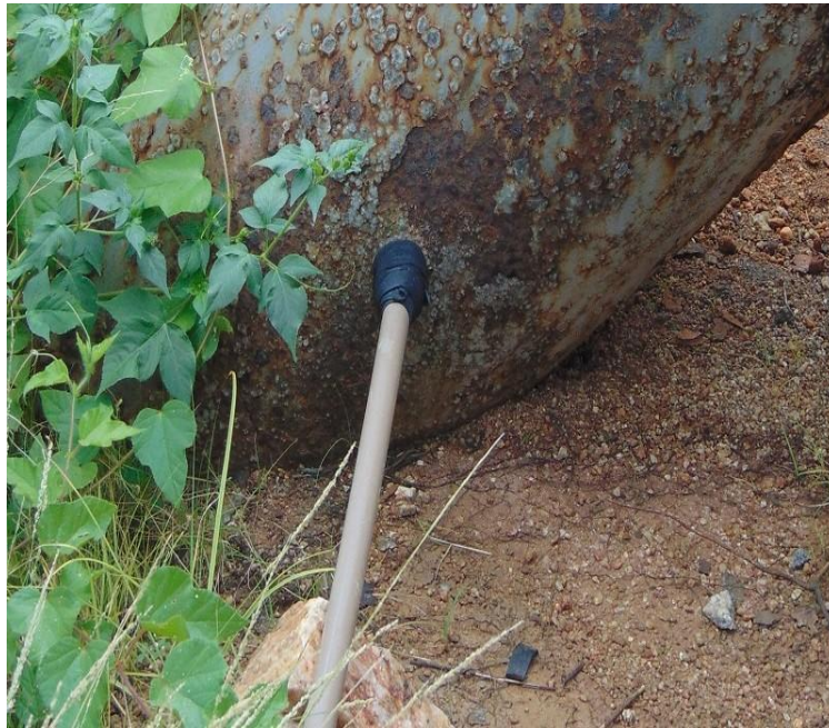
Fotografia 2 – Desvio de água encontrado
