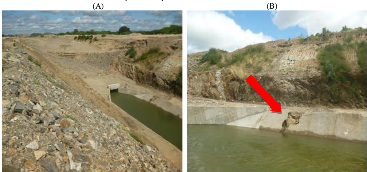
Figura 19. Vista da saída da galeria (A), subsequente ao Túnel Giancarlo, com a respectiva degradação (B-seta), provocada pela ocorrência de chuva.
