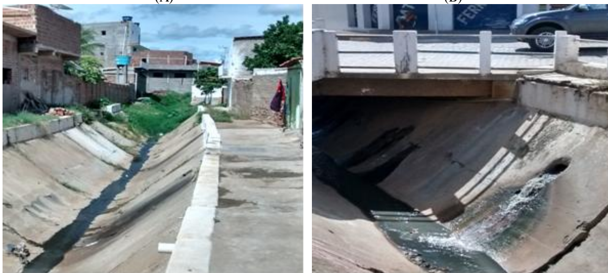
Figura 27. Vistas do canal da rede de águas superficiais (A), com a presença de esgotos (B). (A) (B)
