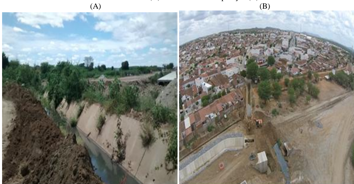
Figura 28. Vistas de uma galeria coletora de águas superficiais da cidade de Monteiro-PB, que deságua no leito do rio do Meio (A) e no canal da transposição (B).
