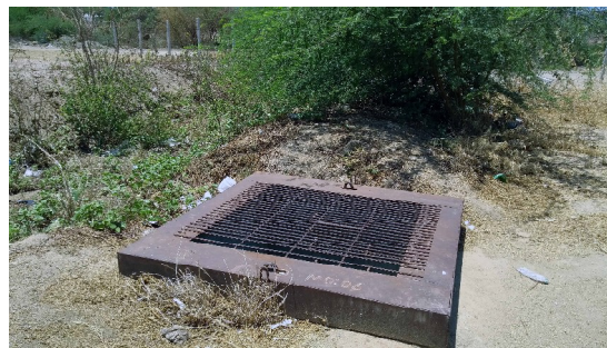
Figura 13 – Caixa de manutenção do canal da transposição
