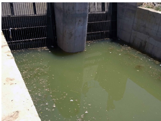
Figura 07 – Comportas de controle de vazão
