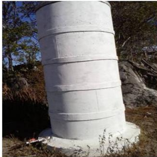
Figura 39. Reservatório para contenção do excesso das águas do poço.
